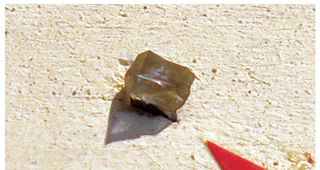
爆風で飛ばされ、壁に刺さった窓ガラス（江波山気象館）。
